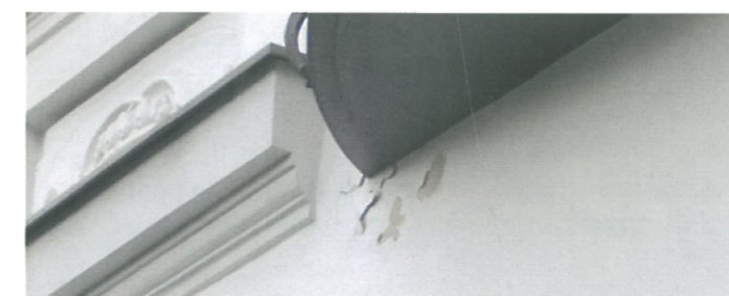
Unter den Balkonen löste sich die alte Farbe.
